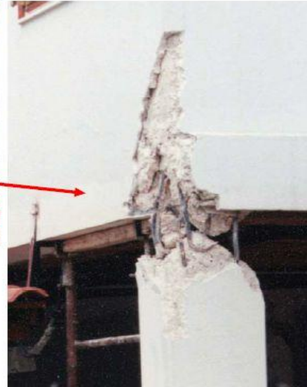
Εικόνα 2: Αστοχία αγκύρωσης των διαμήκων ράβδων. [3]
